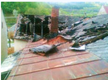
Silne poškodená strecha fary po požiari
