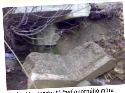
Podmytá a spadnutá časť oporného múra mosta pod hornými bytovkami
