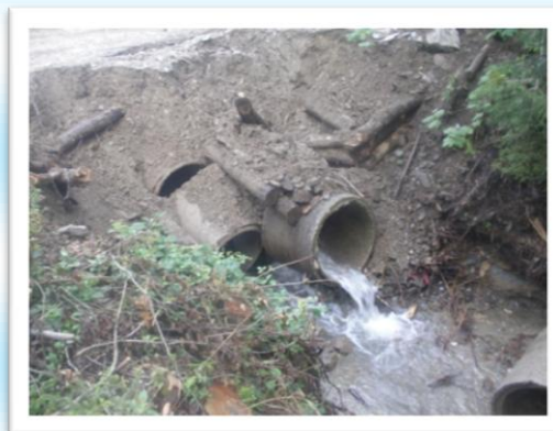
Škody spôsobené povodňou
